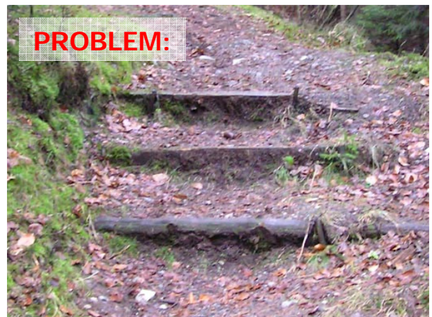
Abb. 34: Treppe mit überstehenden Eisenarmierungen
