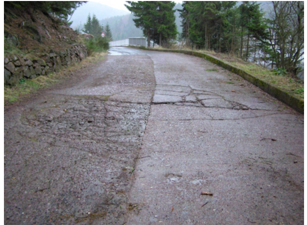
Abb. 28: Auch Betonplatten oder Asphaltdecken können – obwohl sie an sich wartungsarm sind – altern und unbenutzbar werden.
