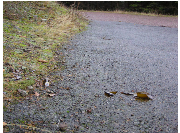
Abb. 59: Glasscherben können für Rollstuhlnutzer unangenehm werden
