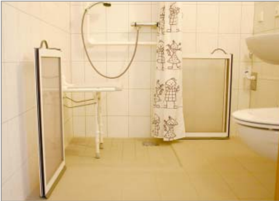
Umbau zum ebenerdigen Duschbereich mit Abwasserpumpsystem für bodengleiche Duschen in jeder Etage. Foto: GWG-ARCHIV
